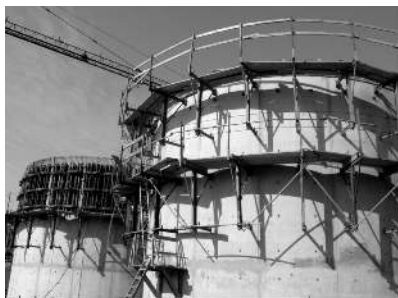
Komory fermentacyjne w oczyszczalni ścieków przy ul. Krzeszowskiej
