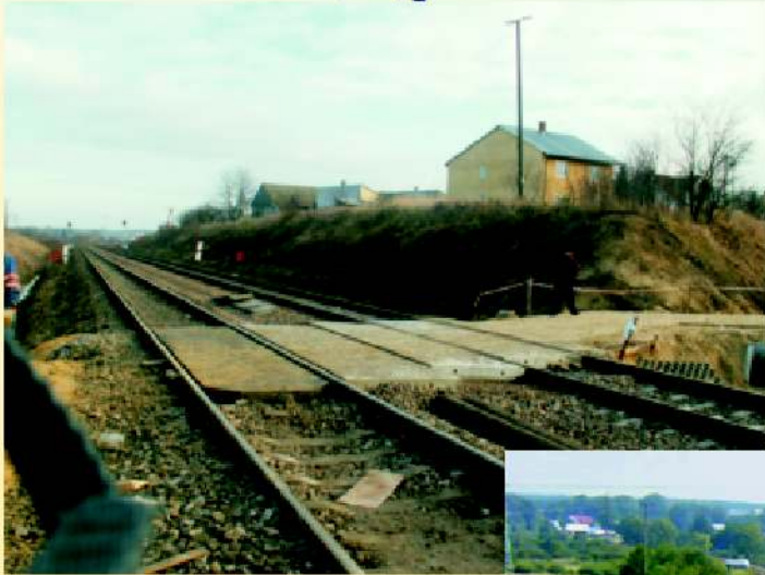
Niebezpieczne przejście przez tory kolejowe, ul. Janowska.
