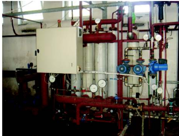
Dwufunkcyjny węzeł kompaktowy w jednej z wymiennikowni ciepła.
