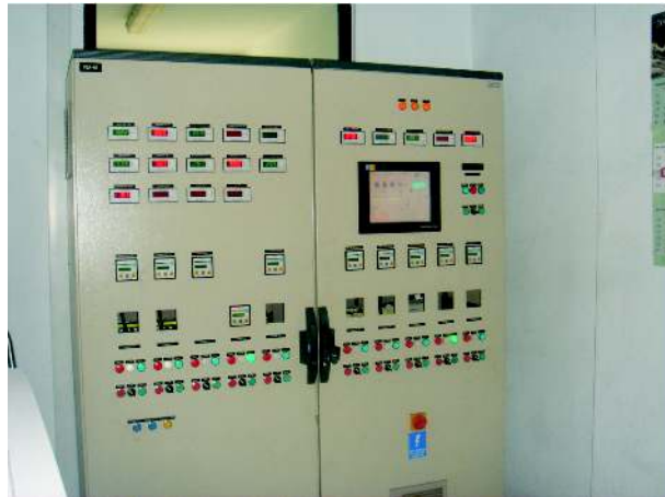
Pomieszczenie sterowni w ciepłowni.
