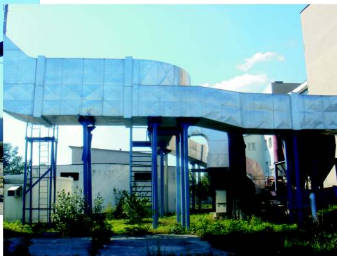
Ciąg odpylania spalin w ciepłowni.
