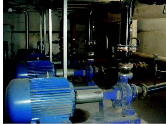
Nowa pompownia w Ciepłowni.
