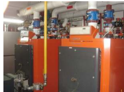
Kotłownia gazowa o mocy 2,24 MW przy Placu Wolności 9.
