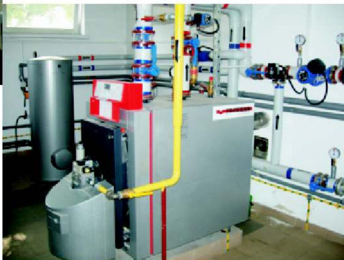
Nowoczesne urządzenia kotłowni w Miejskiej Oczyszczalni Ścieków
