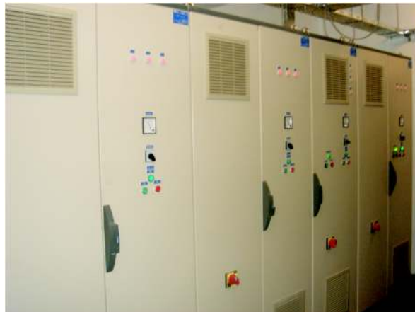
Szafy sterownicze pomp obiegowych z falownikami w ciepłowni.
