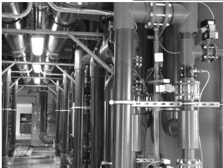
Stacja uzdatniania wody- odżelaziacze
