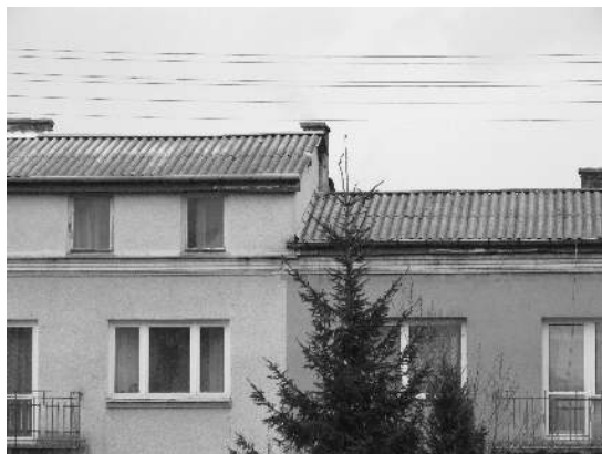
Azbest stanowi pokrycie dachowe na wielu budynkach w naszym mieście
